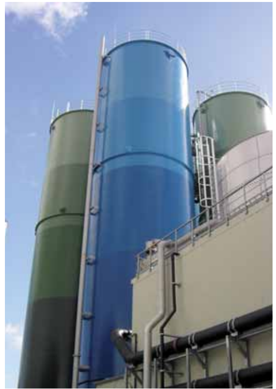
Die neue Anaerobanlage
